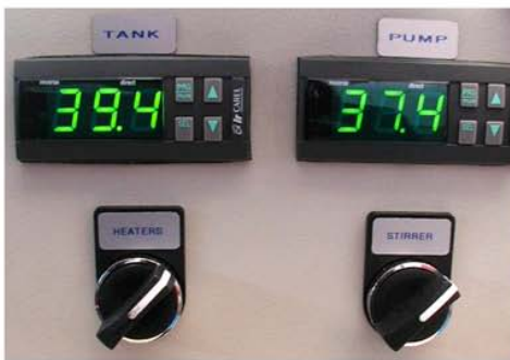
Pannello di controllo del sistema di riscaldamento delle pompe e del serbatoio
